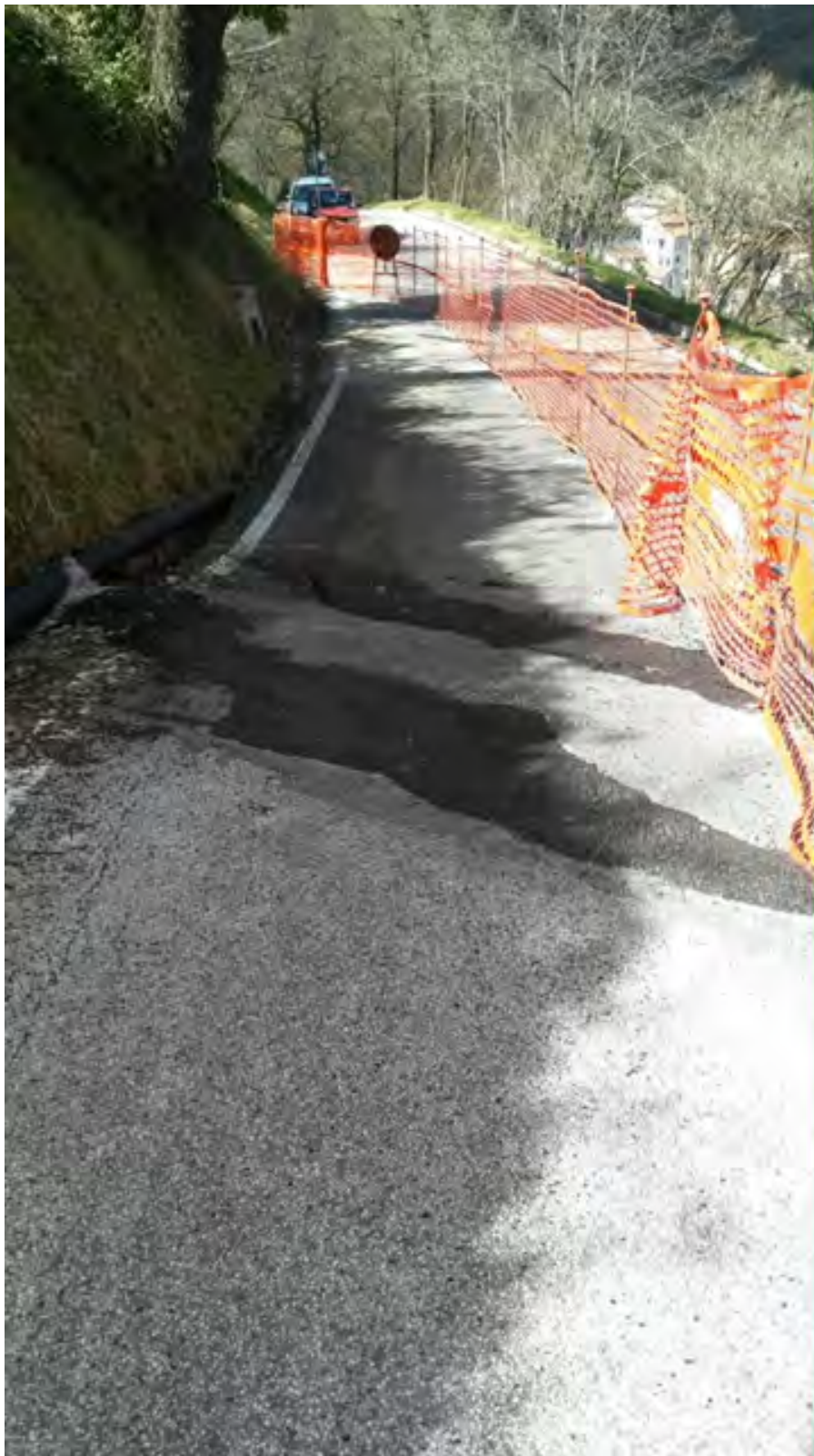
Figura 39: frana su strada in zona alto collinare
